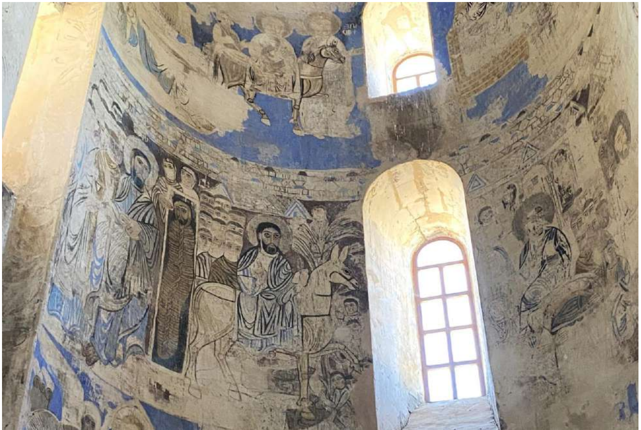
Détails de l'une des fresques, dégradées, à l'intérieur de l'église. À gauche de la fenêtre : la Résurrection de Lazare puis l' Entrée du Christ à Jérusalem .
