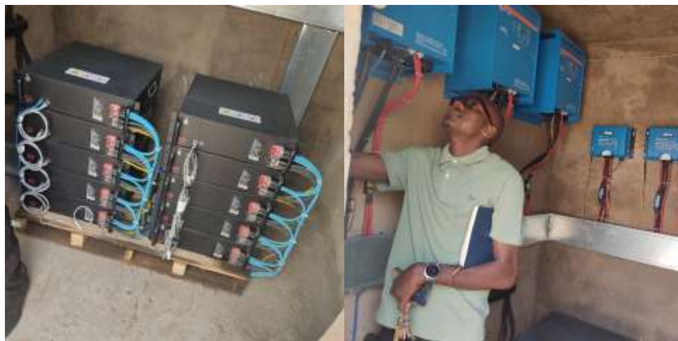
Local technique du champ solaire
